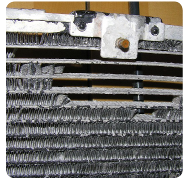
冷凝器腐蚀导致数排翅片缺失
